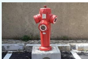
Mise aux normes du réseau de défense incendie par secteur
